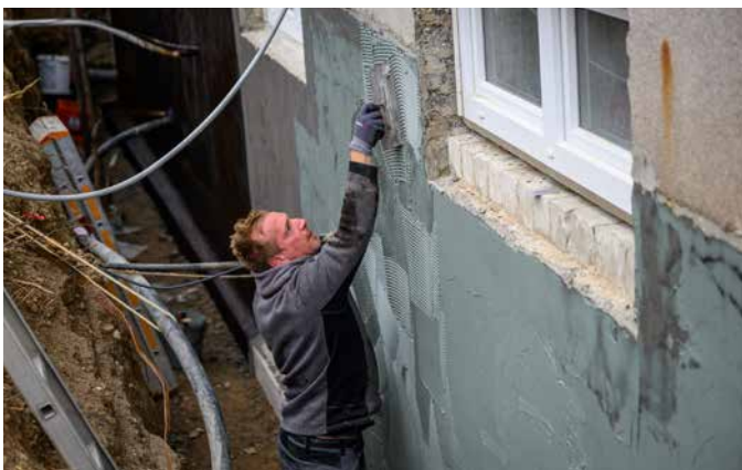
11 Die Abdichtungsschicht wird an die Bereiche von Kellerfenstern herangeführt. Diese werden im Nachgang in die Flächenabdichtung eingedichtet.
