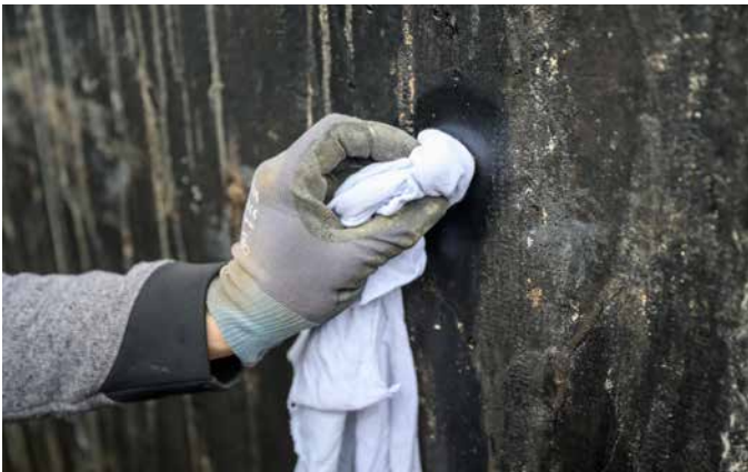
Durchführung der Wischprüfung. Keine Färbung: Ein Anlösen des alten Anstriches hat sich nicht gezeigt. Es handelt sich mit sehr hoher Sicherheit um einen Teerpechanstrich.
