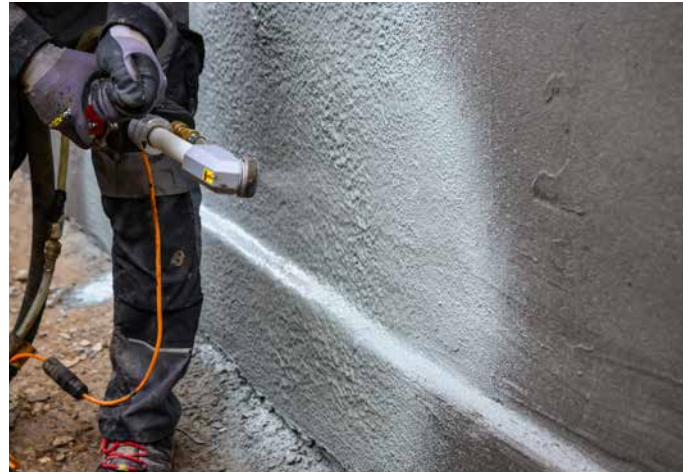
Mit Hilfe der Spritztechnik können schnelle Fortschritte bei den Abdichtungsarbeiten mit FPD erzielt werden.
