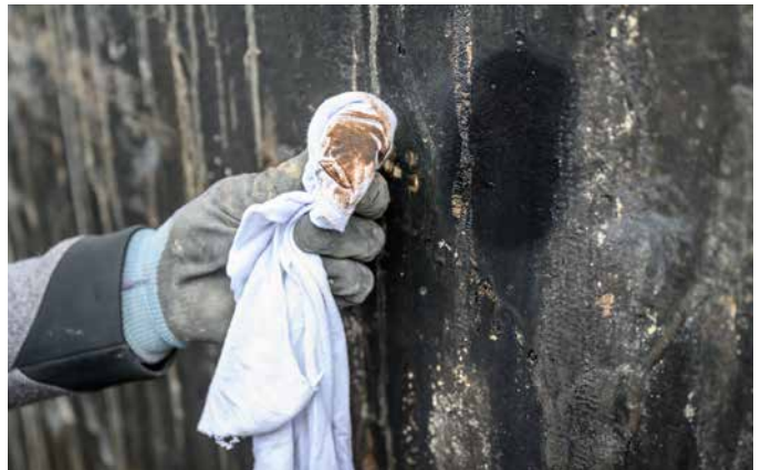
Braunfärbung: Die Fläche lässt sich anlösen. Es handelt sich mit hoher Wahrscheinlichkeit um einen Bitumenanstrich. Die Fläche ist nach gründlicher Reinigung mit einer Bitumendickbeschichtung überarbeitbar und abdichtbar.
