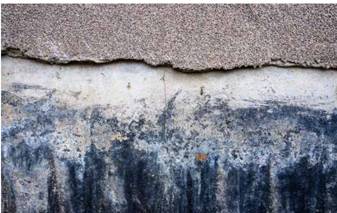
Übergänge der Altabdichtung zum Sockelbereich müssen im neuen Abdichtungskonzept besonders berücksichtigt werden.
