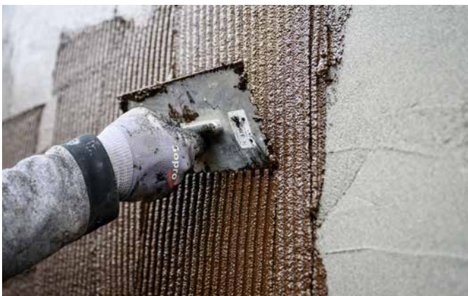
5 Sopro KMB Flex 2-K Poly wird in ausreichender Schichtstärke in zwei Schichten aufgetragen.
