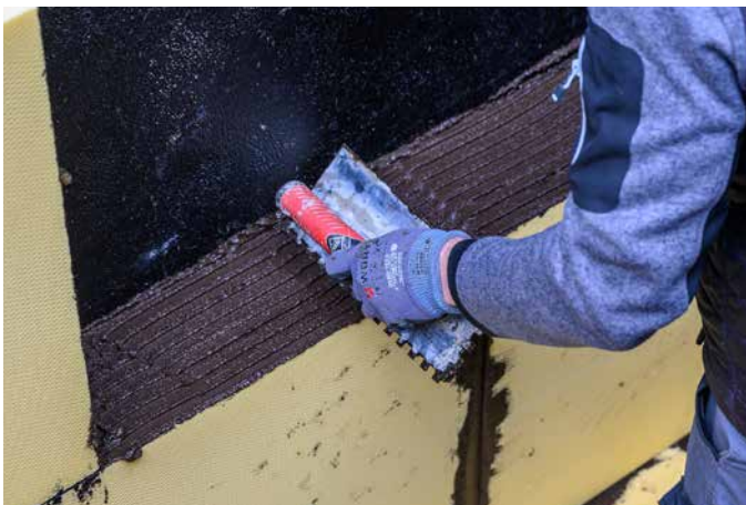
5 Im Druckwasserbereich werden die Plattenstöße vollflächig verklebt, um einem Wassereintritt hinter die Dämmung vorzubeugen.
