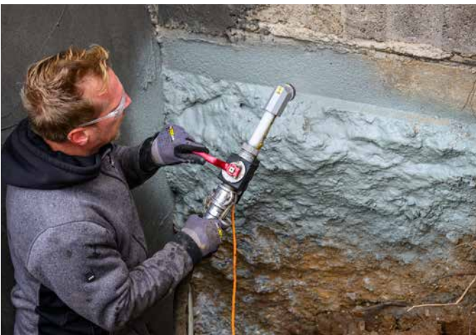
Auch auf unebenen Untergründen kann die Spritztechnik problemlos eingesetzt werden, um Flächen abzudichten.
