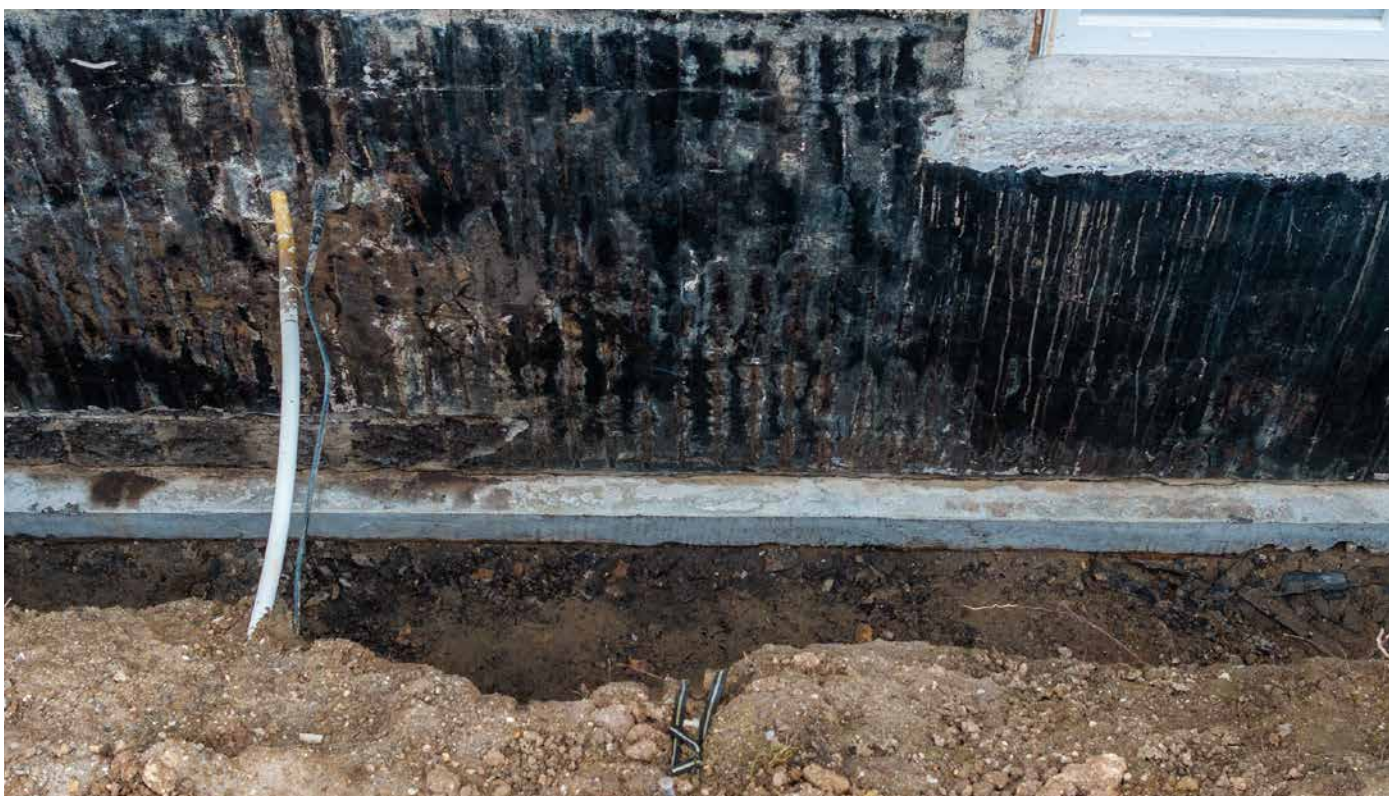
Freigelegte, schadhafte Altabdichtung
