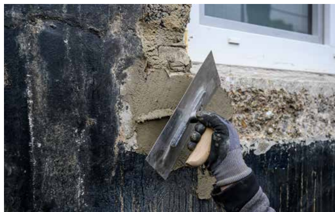
Ausbrücke am Mauerwerk, z. B. im Bereich neu eingebauter Kellerfenster, werden mit Sopro RAM 3® geschlossen.
