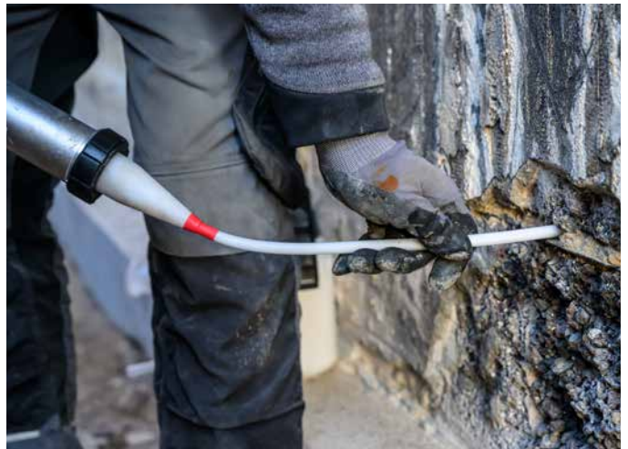
Sopro Verkieselung Gel wird in das zu sanierende Mauerwerk mit Hilfe einer Schlauchbeutelpresse sowie den beiliegenden Injektionsspitzen in die Bohrlöcher eingebracht.
