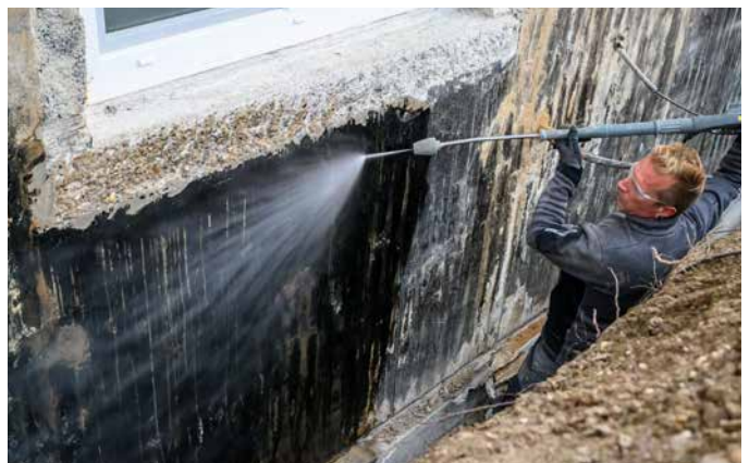
Altabdichtungen oder Anstriche werden vor der weiteren Untergrundbearbeitung von Schmutz und haftungsmindernden Stoffen gereinigt.
