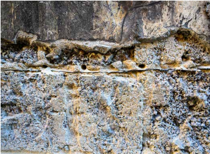
Die Bohrlöcher werden in einem Abstand von max. 12 cm ausgeführt (mind. 10 cm über Sockelhöhe). Die Bohrung erfolgt jeweils waagrecht in den Lagerfugen.
