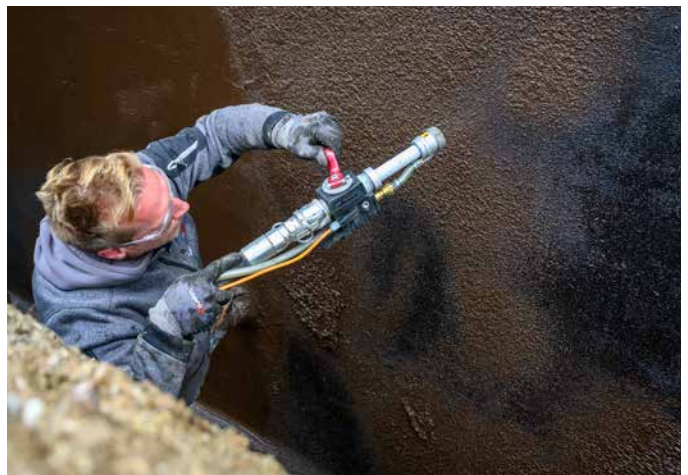
Mit Hilfe der Spritztechnik können schnelle Fortschritte bei den Abdichtungsarbeiten mit PMBC erzielt werden.
