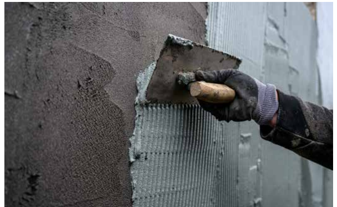
10 Nach Durchtrocknung der ersten Abdichtungsschicht kann die zweite Schicht ZR Turbo MAXX aufgetragen werden.
