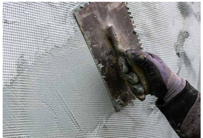
Das Armierungsgewebe wird dabei in die erste Abdichtungsschicht eingebettet und vollständig überarbeitet.
