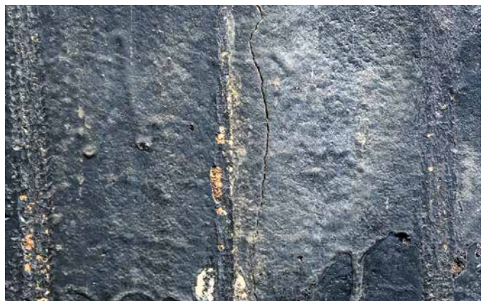
Risse in der Altabdichtung müssen ebenso im Abdichtungskonzept bzw. bei der Wahl der Materialien (z. B. Einlage eines Armierungsgewebes) berücksichtigt werden.
