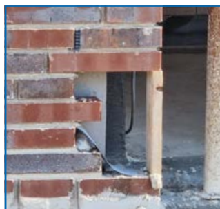
Ein nachträgliches Einfügen von Verblendern ist nicht mehr notwendig
