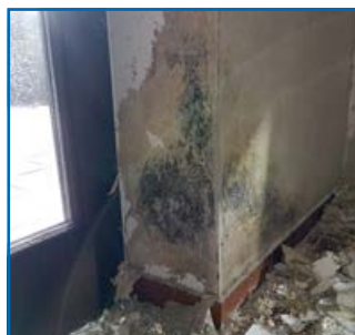
Feuchtigkeit und Schimmelbildung im Innenbereich
